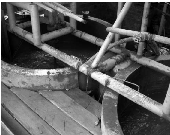
Foto 30: Planta de cianurización.
